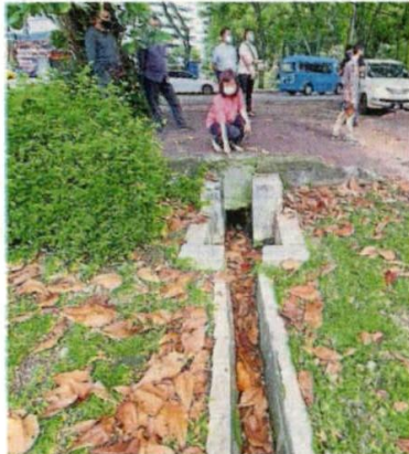
叶子掉落沟渠内，容易给沟渠造成堵塞。
